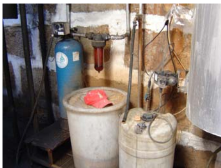
Figura 17 – Sistema de tratamento de água de consumo para a caldeira
