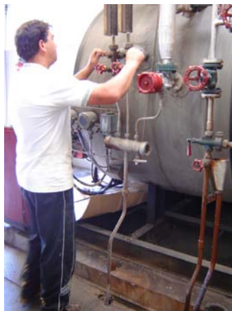
Figura 18 – Operação de purga de águas residuais da caldeira
