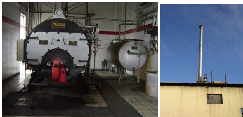
Figura 30 – Caldeira para produção de vapor e chaminé de exaustão
